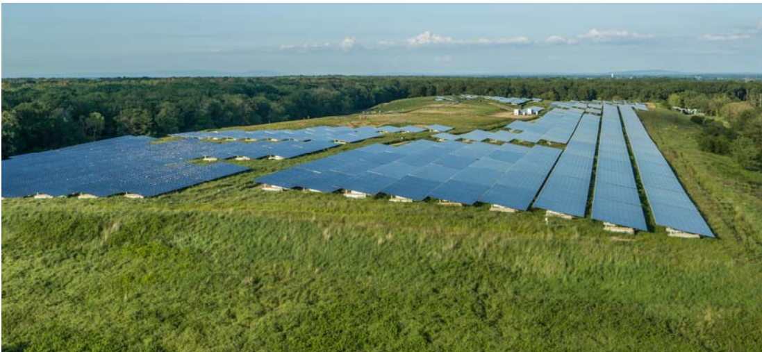
Installation photovoltaïque au sol sur site dégradé (ancienne décharge) à Chézy dans l'Allier
